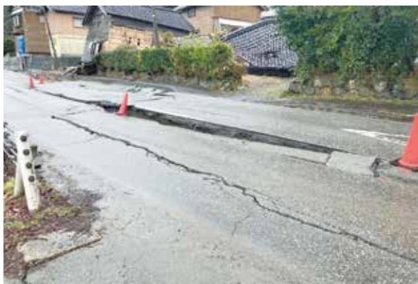
地震により道路が分断されている
